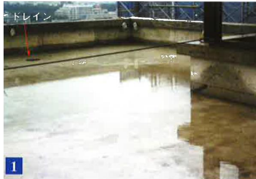
排水不良による屋上への滞水
